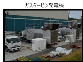
ガスタービン発電機
