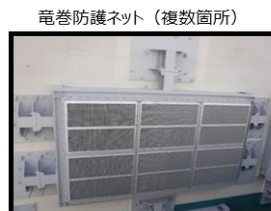
電巻防護ネット（複数箇所）
