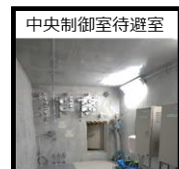
中央制御室待避室
