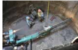
※2 壁を補強するためのボルトを入れる穴を掘っています
