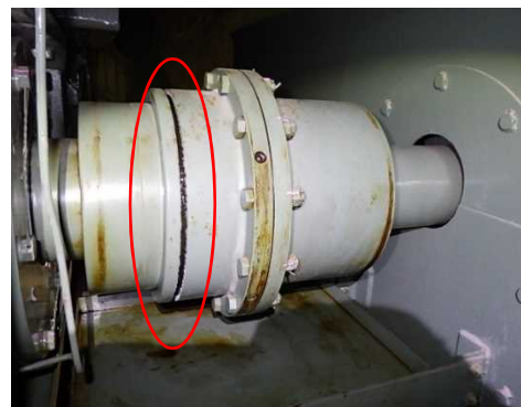
ギアカップリングカバー損傷部
