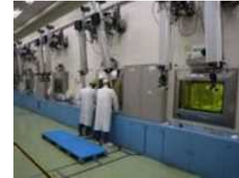
コンクリートセルの例※1
