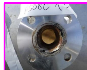
ベント管フランジ部（交換修理前）
