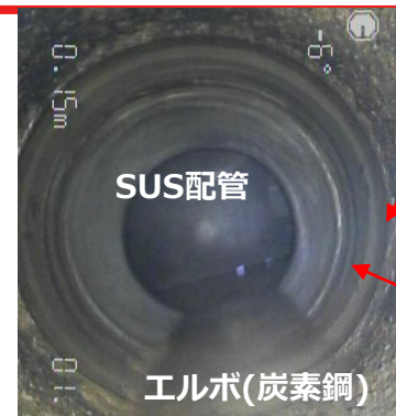
3 SUS側と炭素鋼の異材溶接部
