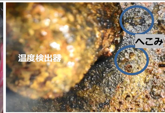
6 温度検出器(鞘管)の下流側
