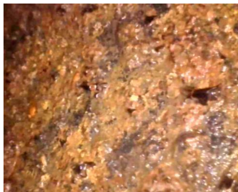
4 減肉傾向箇所Ⅰ(温度検出器の上流側)
