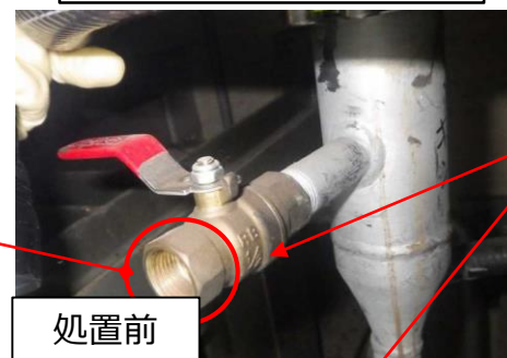
ベント弁の現場状況
