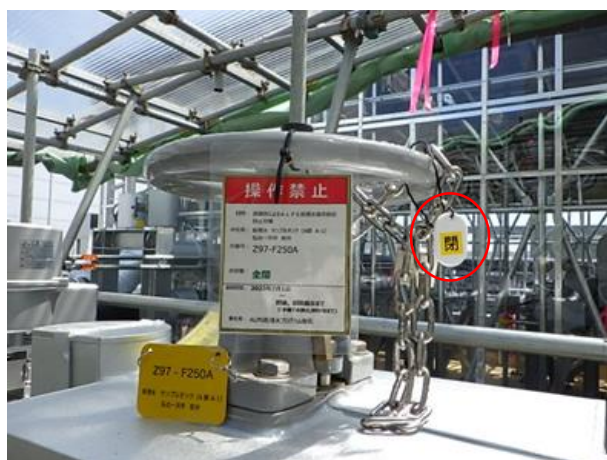
作業中における弁の開閉状態表示
