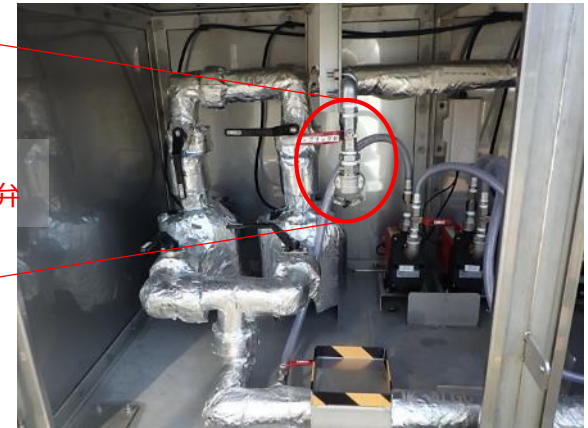
ポンプユニットの現場状況
