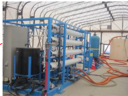
淡水化装置（RO装置）
