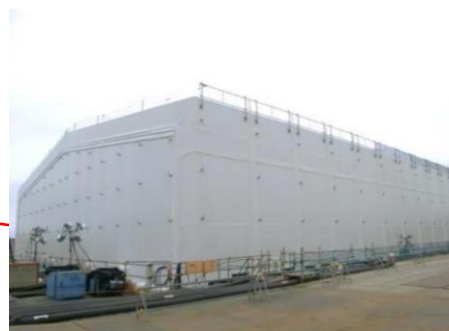
多核種除去設備（ALPS）
