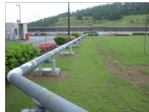
地上化された配管(5号機)
