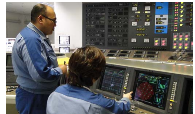
制御棒の操作(中央制御室)
