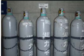
予備ポンプの配備
