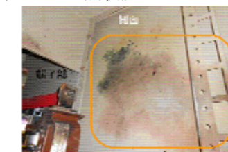
5 Aユニット側面のアーク痕状況
