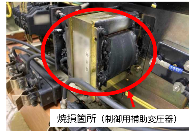
<取り出した制御機器>
