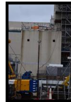
フィルタベント設備（地上式）
