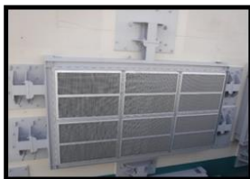
電巻防護ネット（複数箇所）
