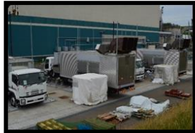
ガスタービン発電機
