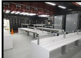
原子炉建屋内緊急時対策所
