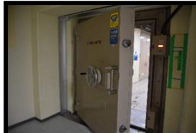
水密扉等の浸水防護対策
