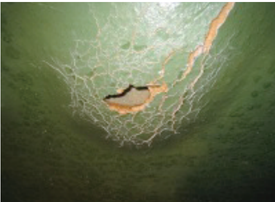
①既設断熱防水の不具合（浮き、破損）
